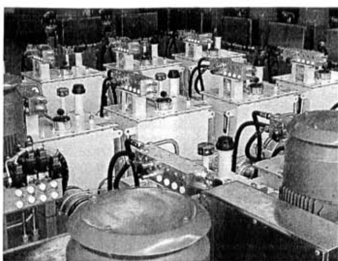
Großprojekte sind interdisziplinäre Treffen aller Fachleute, die an der Konzeption von Hydraulik-Anlagen beteiligt sind.
